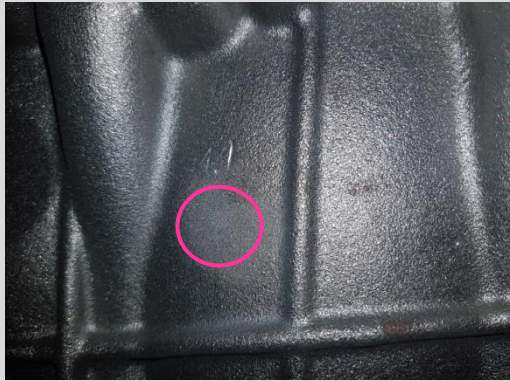
Geschweißte Fehlstelle Wandstärke ca. 3,5 mm
